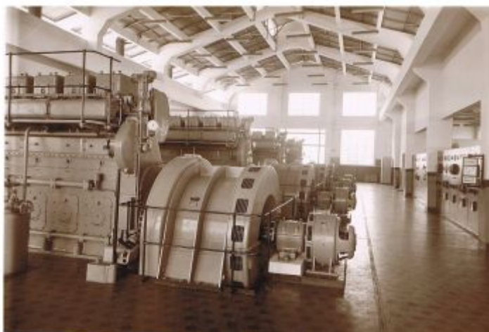
Diesel-elektrische Zentrale Val de Caes, Belem do Parà, Brasil
