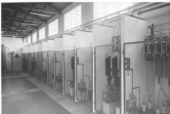
Blick in die Hochspannungszellen mit Transformatoren
